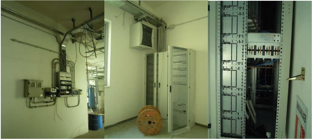
Fig. 7 Vista particolare di alcuni punti e dei quadri dell'impianto elettrico.
