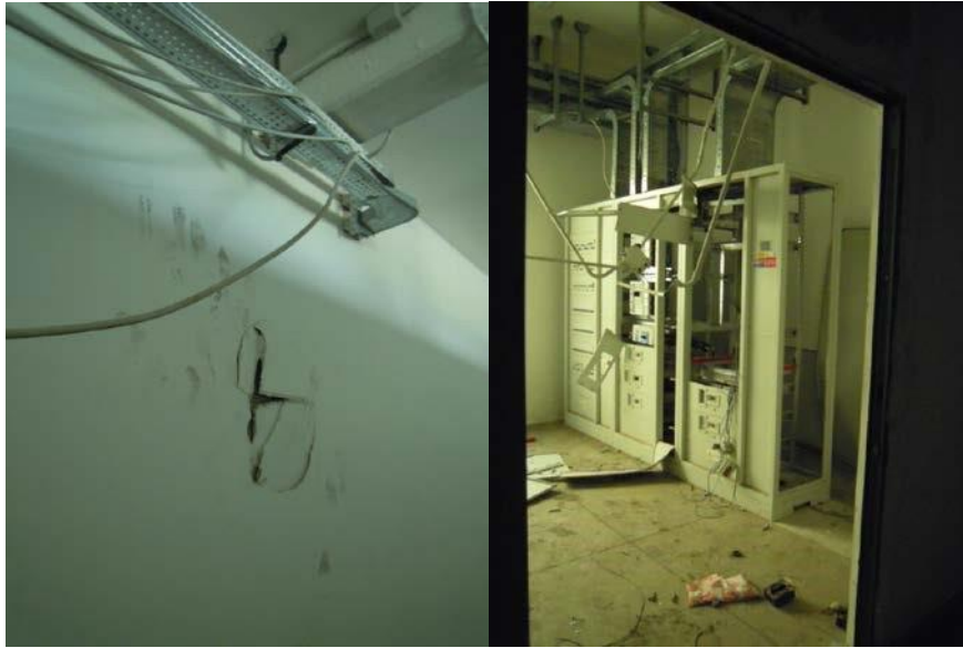
Fig. 4 vista particolare dei danni all'impianto elettrico.
