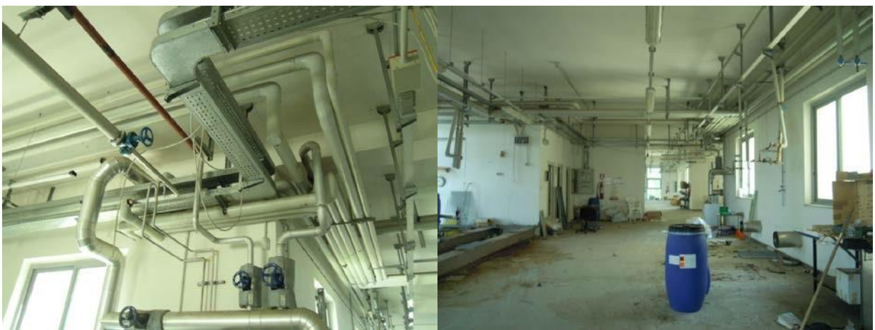
Fig. 9 vista particolare degli impianti.
