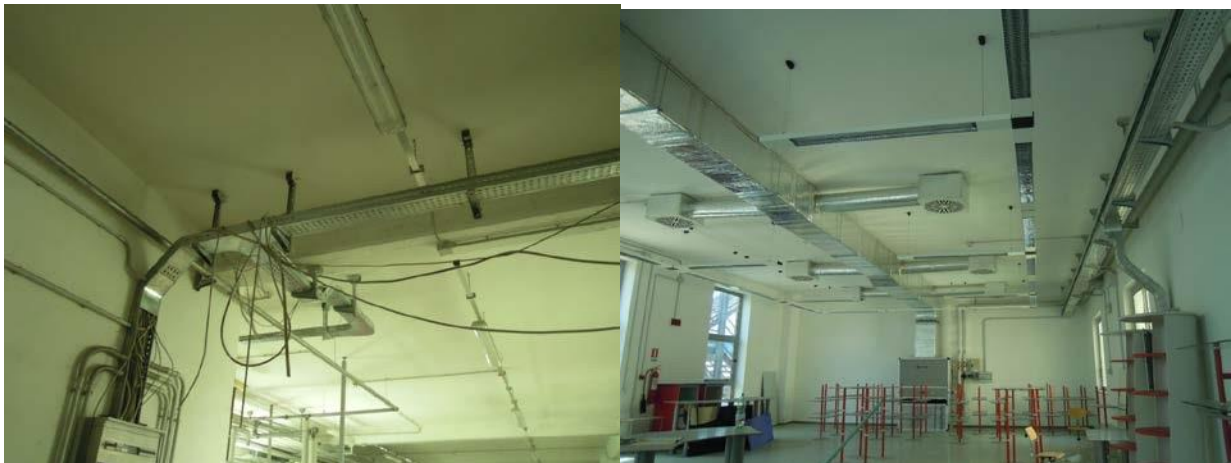
Fig. 6 vista dell'impianto di condizionamento e dell'impianto elettrico.
